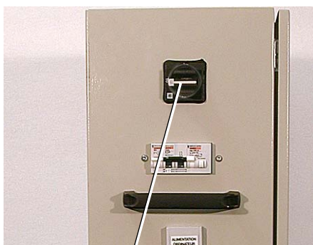
Interrupteur d'alimentation générale (Q10)
